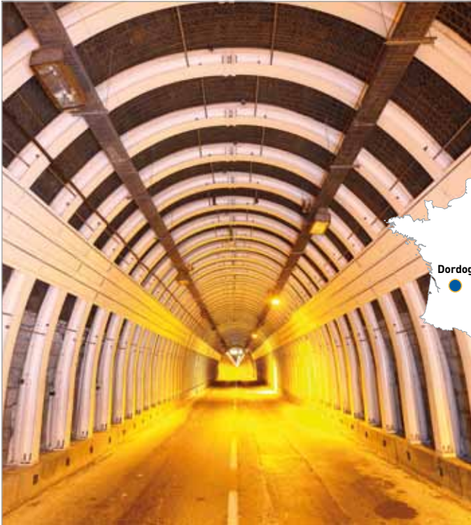
Tunnel de Tende Maître d'ouvrage : Conseil général des Alpes-Maritimes Maître d'œuvre : DDE Alpes-Maritimes Assistant Études : CETU Lyon / CETE Méditerranée
